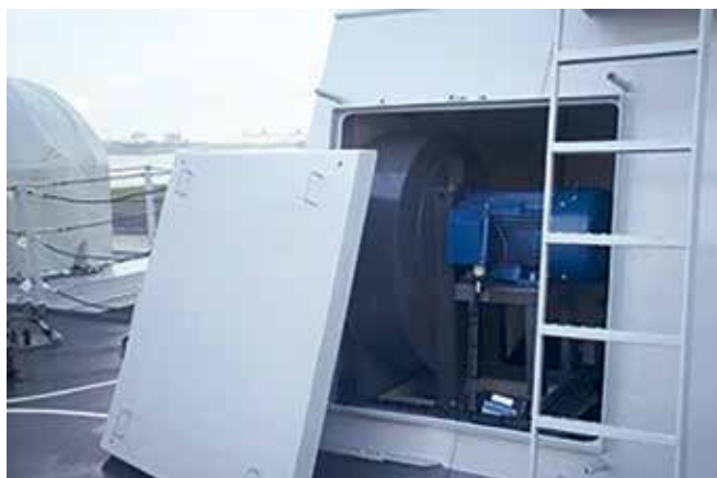
Afbeelding 1: Jet-X-box van een LCF met goed zichtbaar de ventilator die buitenlucht inblaast in de dieselmotoruitlaat
